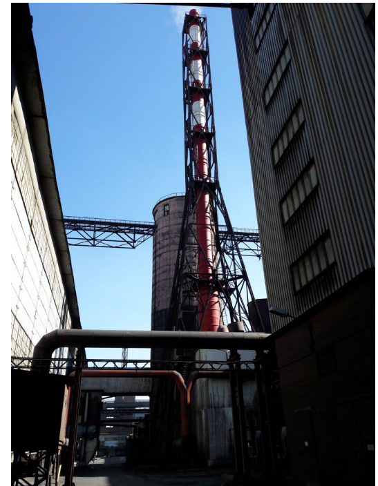
Дымовая труба газоочистной установки
