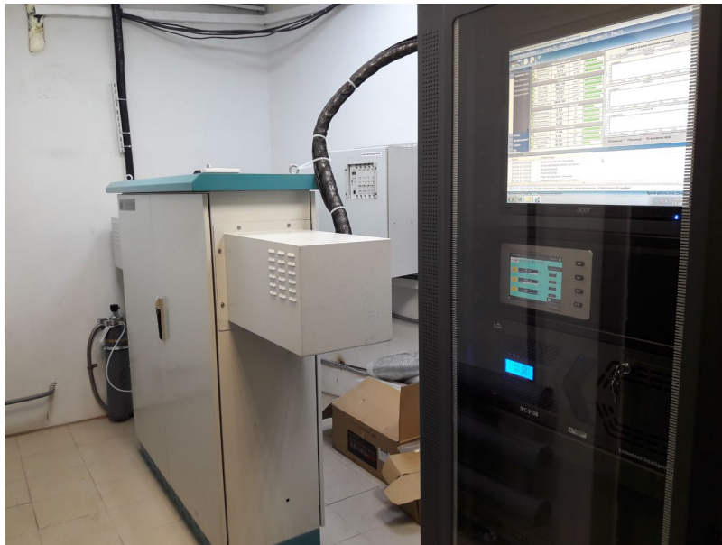
Газоанализатор LGA-4500 для измерения HF (слева) и шкаф с системой управления и газоанализатором ОМА-2000 (справа)
