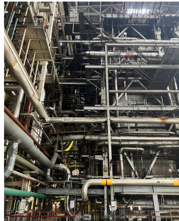
Котельное отделение ТЭЦ-22
